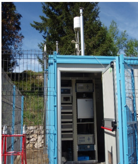
Figura 61. Stație automată de monitorizare a calității aerului în municipiul Reșița
